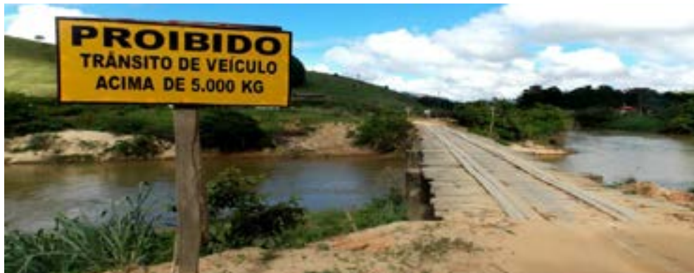
Mesmo com proibição motoristas continuam atravessando a ponte com caminhões carregados
