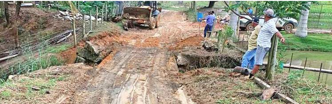
Ponte no Córrego do Alecrim foi recuperada
